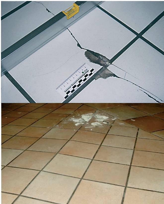
Scherspannungen durch unterschiedliche Ausdehnungskoeffizienten von Belag und Untergrund oder durch junge, noch schwindende Estriche führen zu Belagsrissen und -aufwölbungen.
